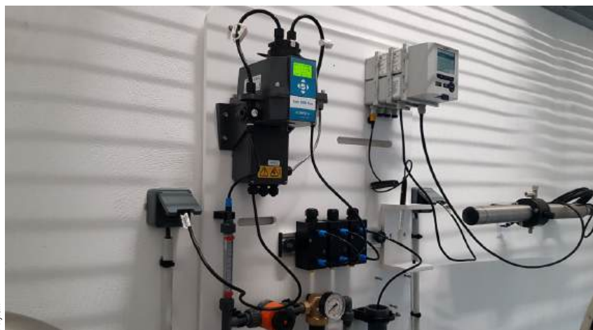
Ce panneau WTW DW/P, couplé à une sonde de mesure UV, de Xylem a été déployé dans une usine de cosmétiques en France.
